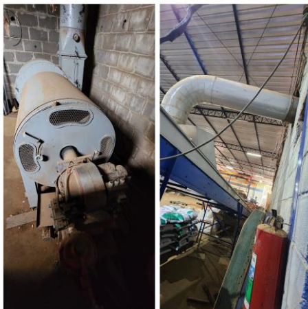
Figura 1a e Figura 1b – Sistema de Geração Circulação de Ar Quente
