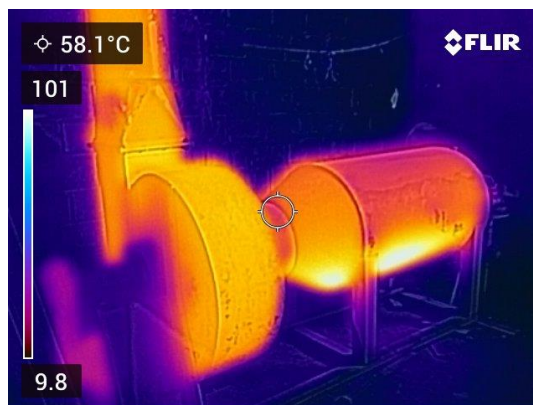
Figura 4 – Imagem termográfica de parte do sistema
