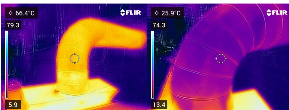
Figura 12a e Figura 12b – Imagem termográfica antes de depois no Ponto 8
